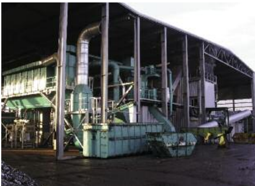
Aufbereitungsanlage für metallhaltige Abfälle, Werk 3, Wörth
